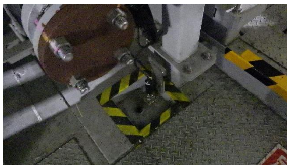
(写真 2－2) 漏えい検知器
