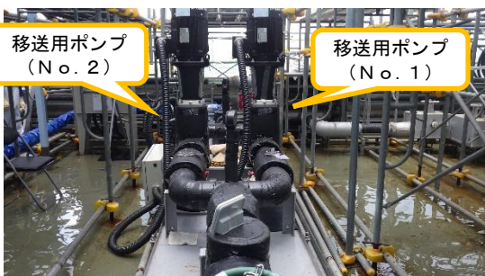
(写真 4－1) 移送用ポンプ（現場確認時は、左側のポンプ（No. 2）が稼働）
