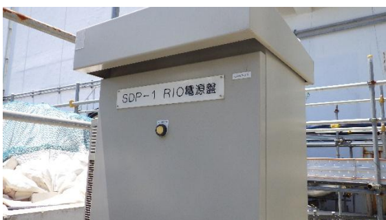
(写真2-4) R/O電源盤の設置状況 (No. 1サブドレン中継タンク)
