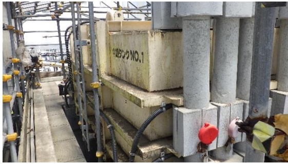
(写真2-1) サブドレン中継タンクの設置状況 (No. 1サブドレン中継タンク)
