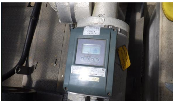
(写真4-1) 流量計の表示状況 (No. 3サブドレン中継タンク移送ポンプ吐出流量計：1.00m 3 /h)
