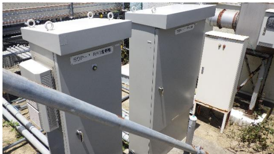
(写真2-3) SDP制御盤の設置状況 (No. 1サブドレン中継タンク)
