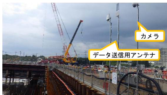
(写真 4－2) エリア内遠隔監視用 カメラ用設置状況
