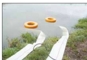
排水元のポンプ設置状況
