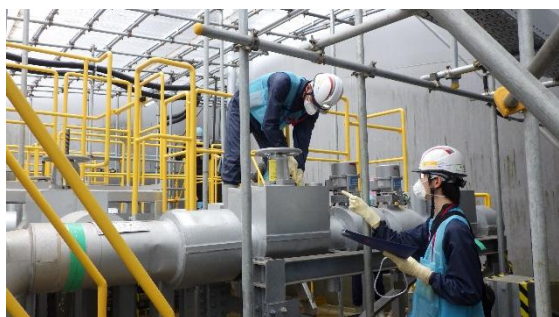
(写真1) 指差呼称による弁の開閉確認の状況
