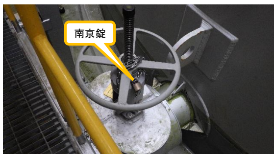
(写真2) 弁操作後の施錠状況
