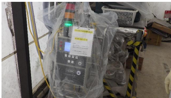
(写真 2－1) 連続ダストモニタの設置状況 (ジャバラハウス B 内)
