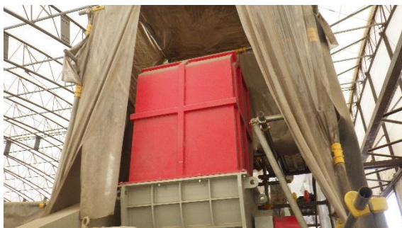
(写真 1－4) ジャバラハウス B 内の破砕機設置状況（南側）
